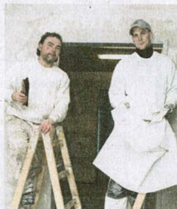
Innenbau: Die Maler Maik Greitschus (links) und Mathias Roß tapezieren die Wohnheimzimmer. FOTO: DABE
